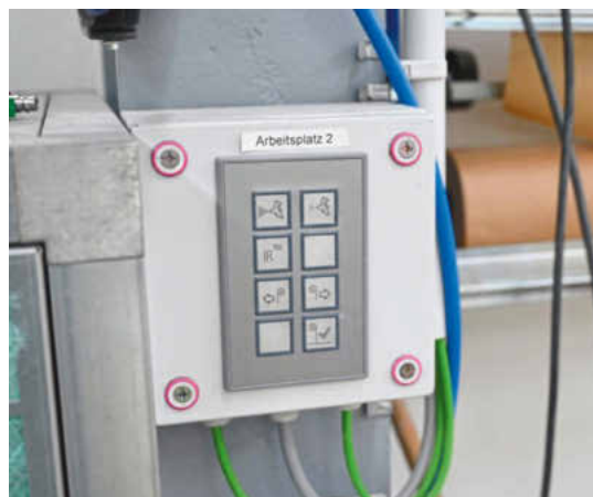
Eine ausgeklügelte Steuerung der Funktionen sorgt an den Vorbereitungsplätzen nicht nur für Komfort, sondern auch für Sicherheit.
